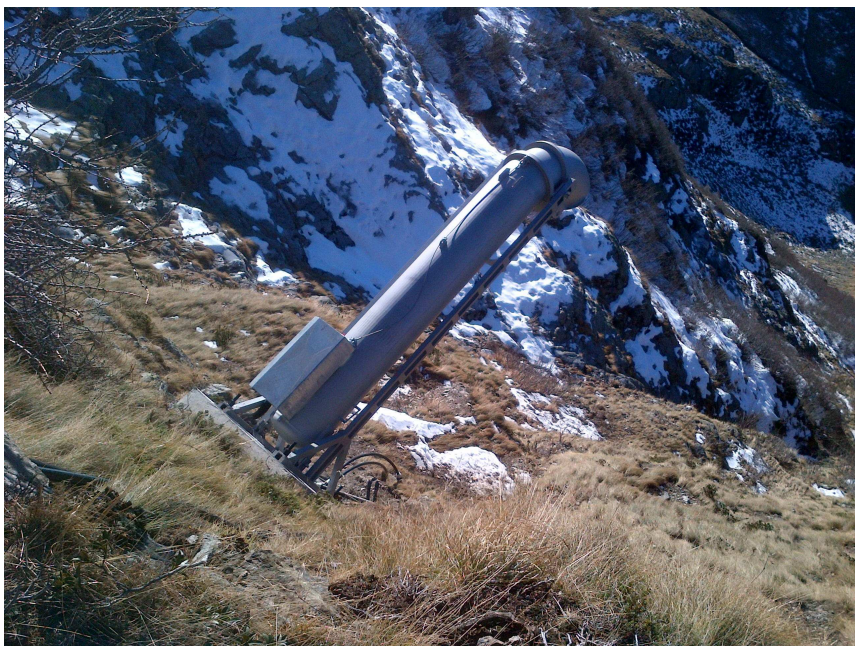
Figura 18: Gaz Ex installato
